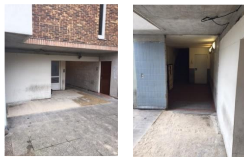
Avant les travaux, des halls lieux de nuisances.
